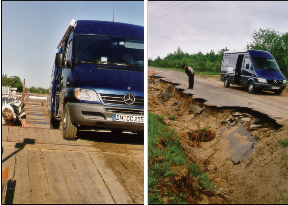
Abbildung 1-5: Anfahrt des Messfahrzeuges mit einem mobilen Ganzkörperzähler in das Messgebiet (Gemeinde Volincy) in Weißrussland über eine Pontonbrücke und unterspülte Straßen
