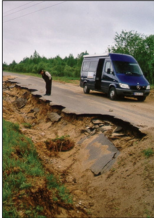
Foto 7: Unterspülte Straße im Speergebiet Strumen zwischen Korma und Volincy (2004)
